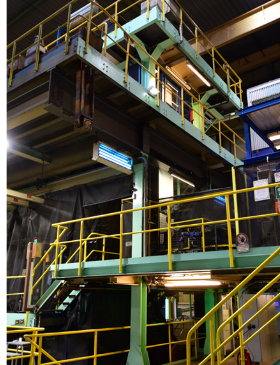
Der Sensor ist am Auslauf der Beschichtungsanlage installiert
