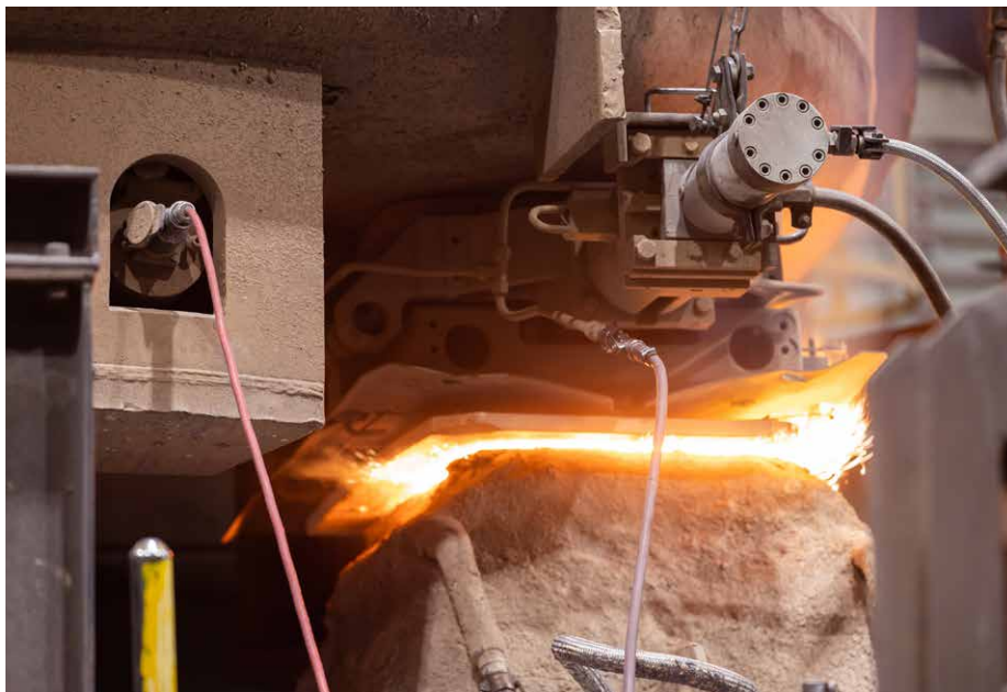
An der Stranggießanlage 3 wurde ein neues ESD 300-System parallel zum bestehenden ESD 100S-System so installiert, dass das Signal einer Sensorspule sowohl vom bestehenden als auch vom neuen Detektionssystem gleichzeitig aufgenommen werden konnte (Bild: SZFG)
